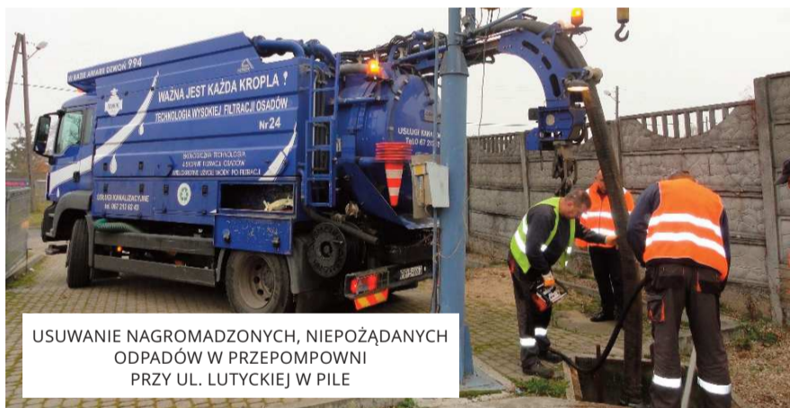
WSTĘPNE OCZYSZCZANIE ŚCIEKÓW W JEDNEJ Z PILSKICH PRZEPOMPOWNI. ZDJĘCIE OBRAZUJE ŚMIECI NIE BĄDĄCE ŚCIEKAMI ZATRZYMANE NA KRACIE WSTĘPNEJ SELEKCJI.
